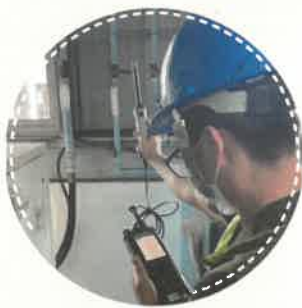
設備機房溫度檢測
