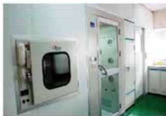
傳遞箱、浴塵室
